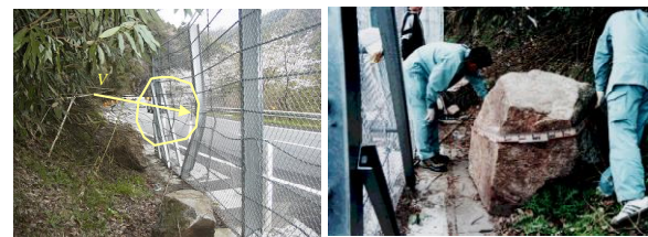
写真 1 ストンガードの変形(玉谷町)
