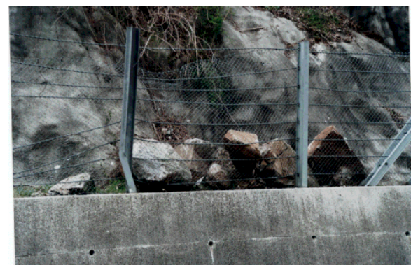
写真 2 芸予地震による東川町での落石
