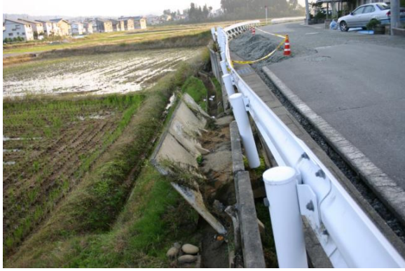
写真 3 小千谷市若葉団地内の道路の L 型擁壁
