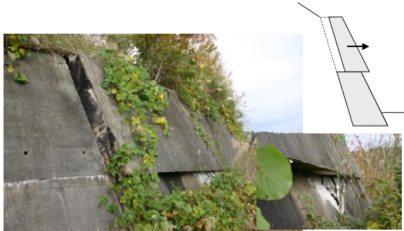
写真 9 重力式擁壁の水平継ぎ目の滑り出し
