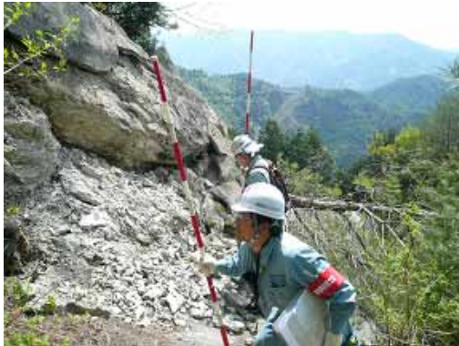
法面の吹付コンクリート，法枠の変状を調査する宮地，森会員
