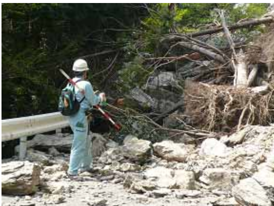
崩壊の幅をテープで測定
